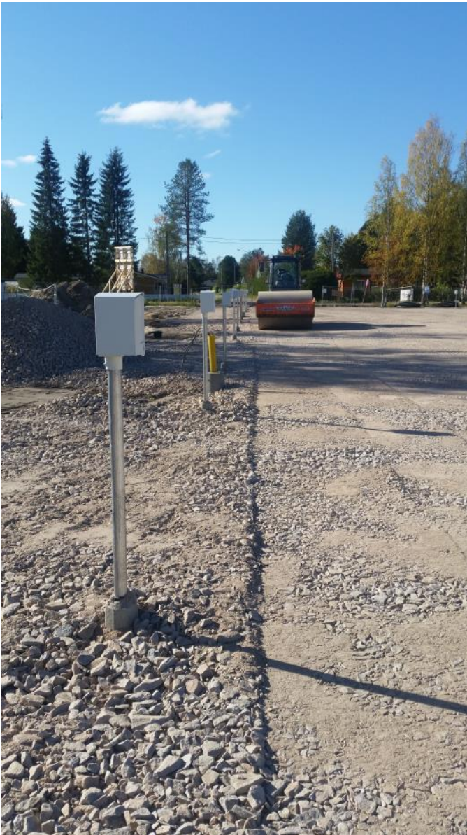
Kuva 1. Parkkipaikalle asennetut auton lämmitystolpat
